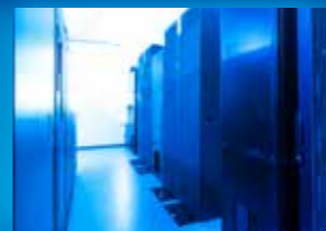
データセンター
