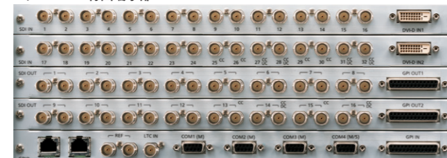
メインフレーム背面端子部
